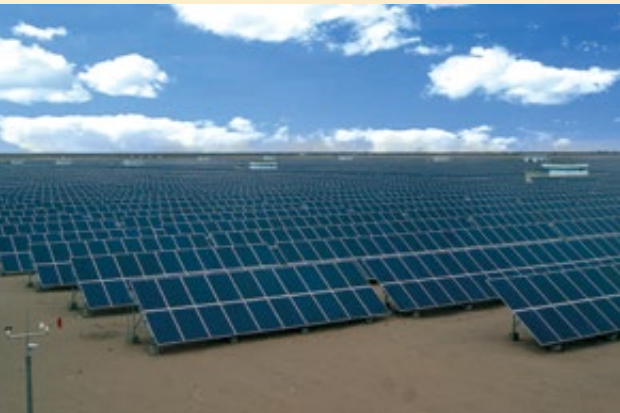
大唐青海格尔木光伏电站——中国大唐首个光伏精品工程
