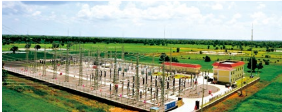
柬埔寨金边 - 菩萨 - 马德望 230 千伏输变电项目
