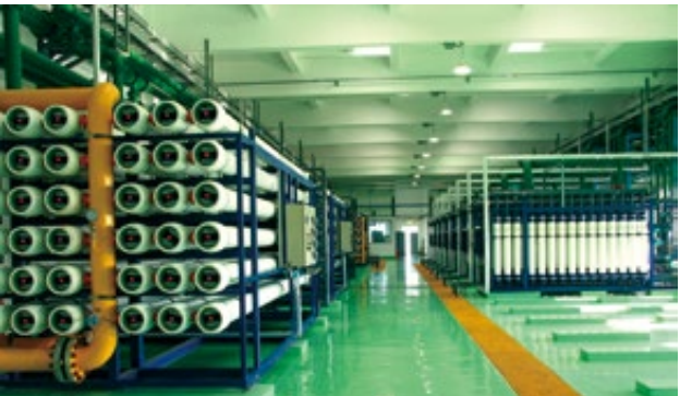
大唐王滩发电公司海水淡化系统
