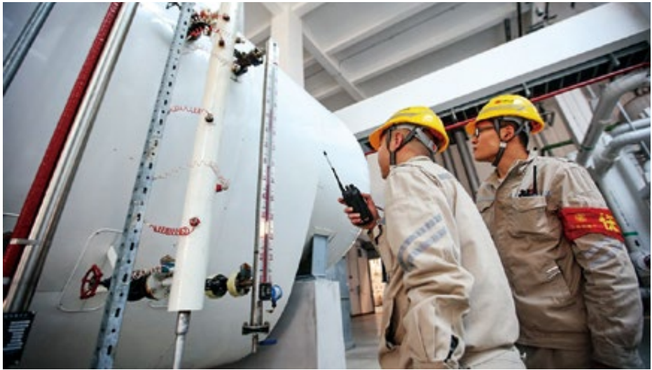
大唐北京高井热电厂保障“两会”期间机组安全稳定运行
