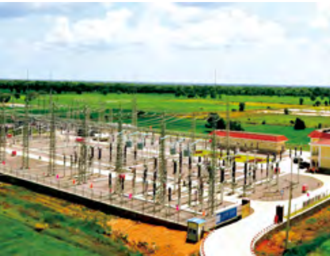
▲ 柬埔寨金边 - 马德望 230 千伏输电项目全年安全稳定运行，对当地电网运行和保障全社会供电作出突出贡献
