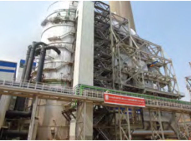
▲ 大唐印度古德洛尔1号脱硫系统顺利通过试运行
