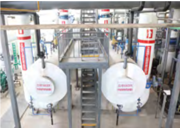
▲ 12月6日，大唐哈尔滨第一热电厂1、2号机组火电灵活性改造二期工程顺利投产。作为国家能源局首批灵活性改造项目，该项目为国内单机容量和总装机容量最大的电极直热锅炉热电解耦工程，电锅炉热效率可达99.11%
