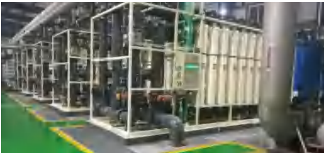
北大沟污水处理系统
