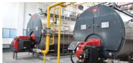
新建 19 蒸吨 / 小时燃气锅炉
