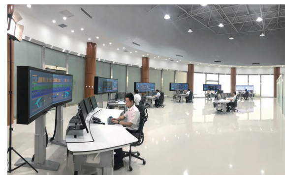
陕煤小保当矿综合自动化项目
