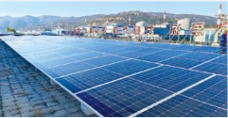
• 田湾核电基地首个屋顶光伏系统
