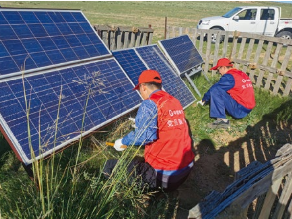
清理村民家庭光伏周边杂草，保障用电安全
