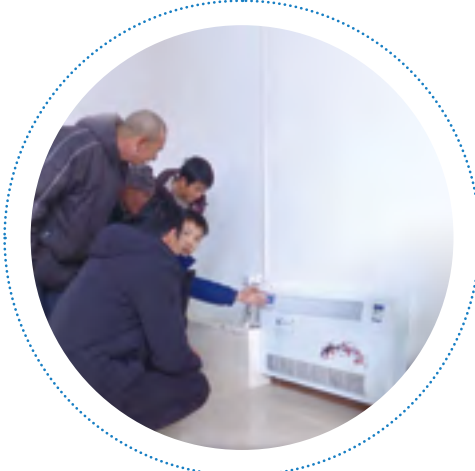
旱天岭村光伏地热三联供一体化示范项目
