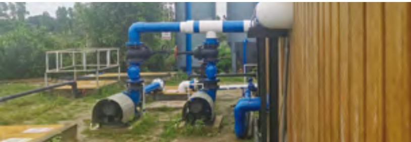
海南核电污水改造设备
