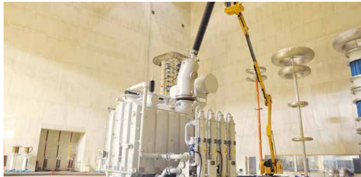
保变电气自主研制的白鹤滩水电站550KV主变压器
