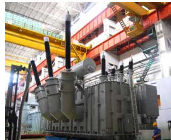
ITER项目主变压器
