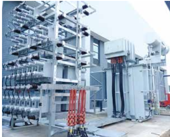
中国散裂中子源项目用储能电抗器
