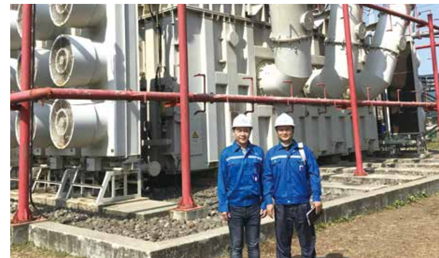
印尼国家电网变压器服务现场
